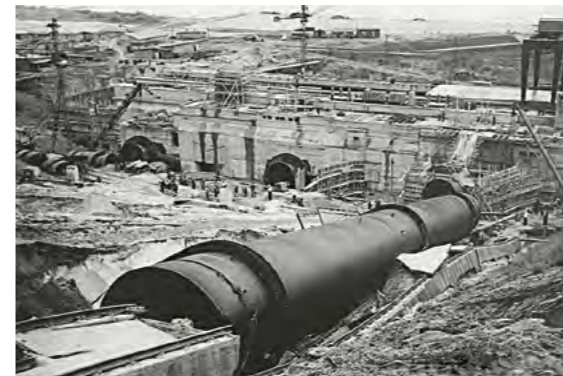
Ungeplant rutscht nach einem Wolkenbruch am 22.07.1957 eine bereits fertig verlegte Rohrbahn am Pumpspeicherbecken wieder ab.
