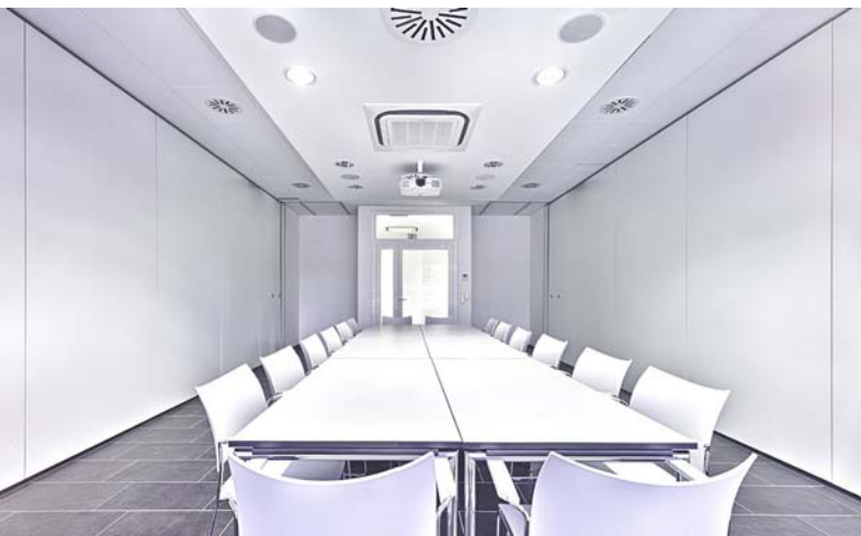
Besprechungsraum: Zwischendeckengerät vierseitig ausblasend
