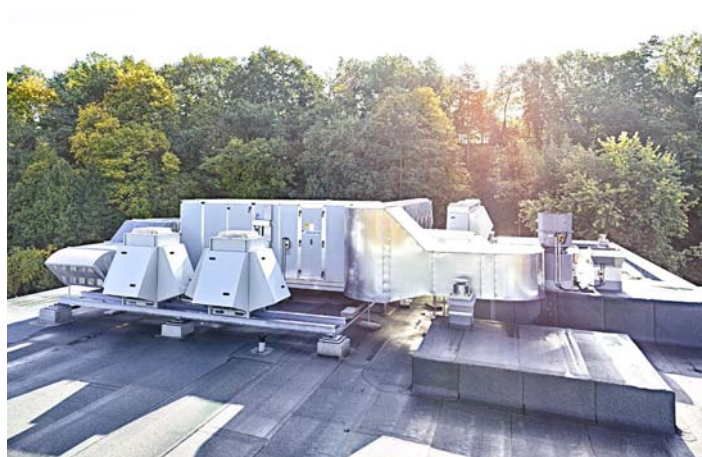
Das Lüftungsgerät mit Verflüssigereinheit „ERQ“ auf dem Dach des Labors
