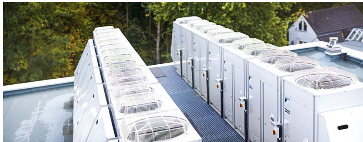
Rund 440 kW Kälteleistung sind auf dem Dach installiert
