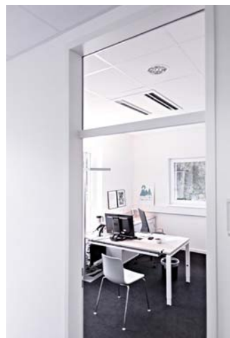
Büro: Zwischendeckengerät zweiseitig ausblasend
